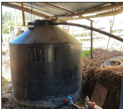
Figura 13 Tanque de Almacenamiento
