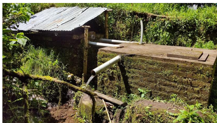
Figura 8 Tanques de Captación
