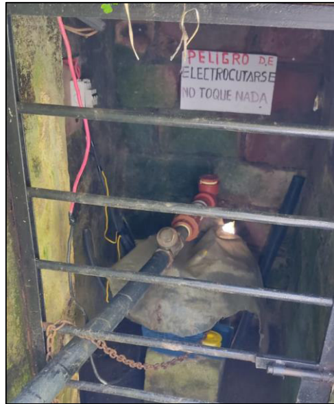
Figura 11 Bomba de Impulsión al Tanque de Almacenamiento
