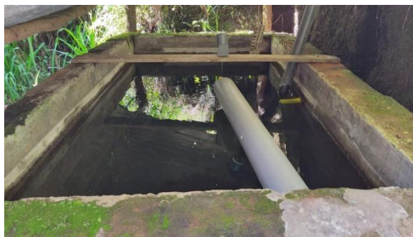
Figura 5 Primer Tanque de Captación
