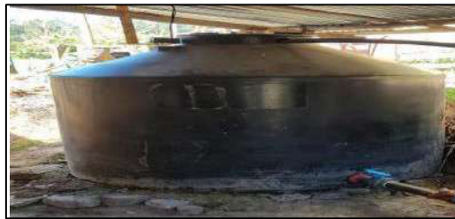
Figura 6. Tanque de desinfección.
