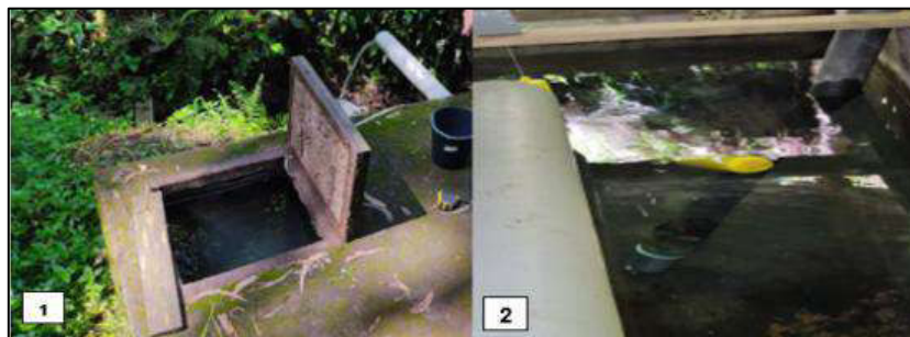
Figura 5. Tanques de captación de agua cruda.
