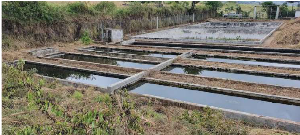
Figura 3.3: Planta de Tratamiento
