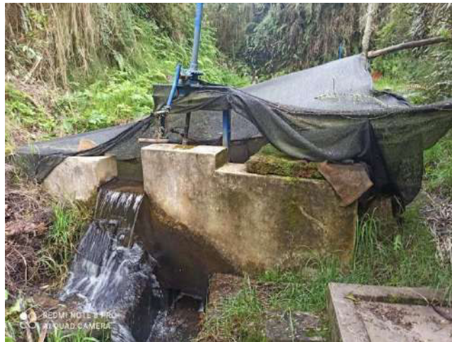
Figura 3.1: Tanque de Captación
