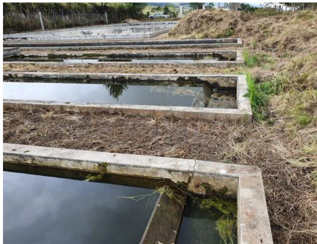
Figura 5 Planta de tratamiento, vista interna.
