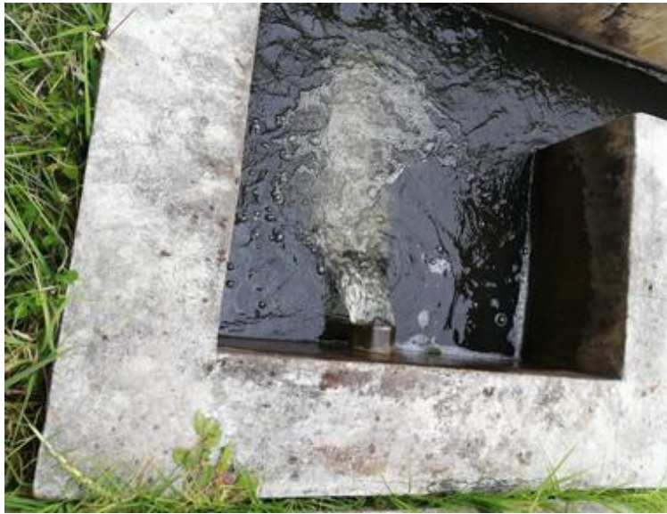
Imagen 4 Tanque de almacenamiento
