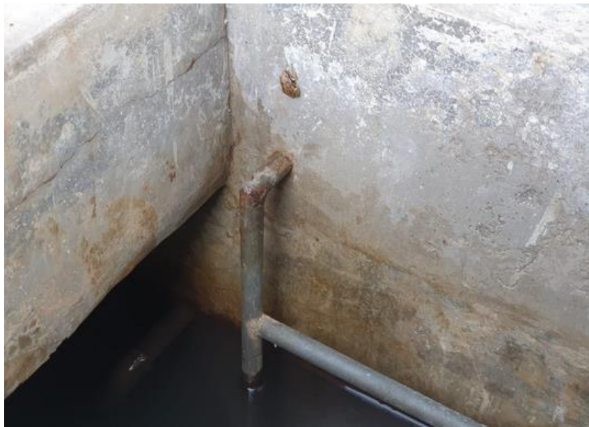
Imagen 5 Tanque de Distribución
