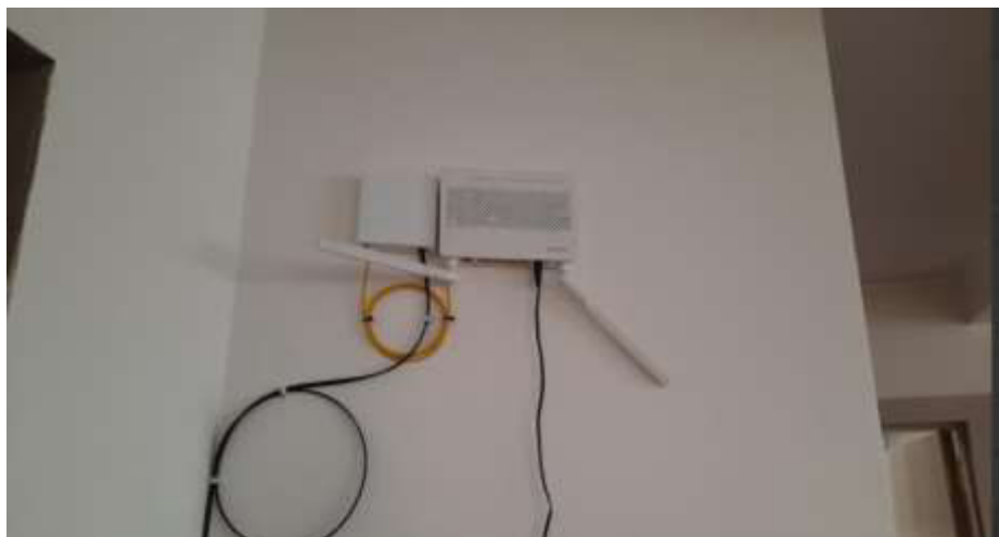
Figura 3.27 Equipo terminal instalado en el domicilio del cliente
