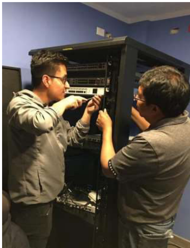
Figura 3.17 Montaje de los equipos activos en el nodo central
