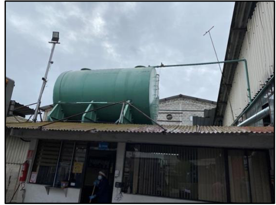
Figura 3.18. Reservorio de agua
