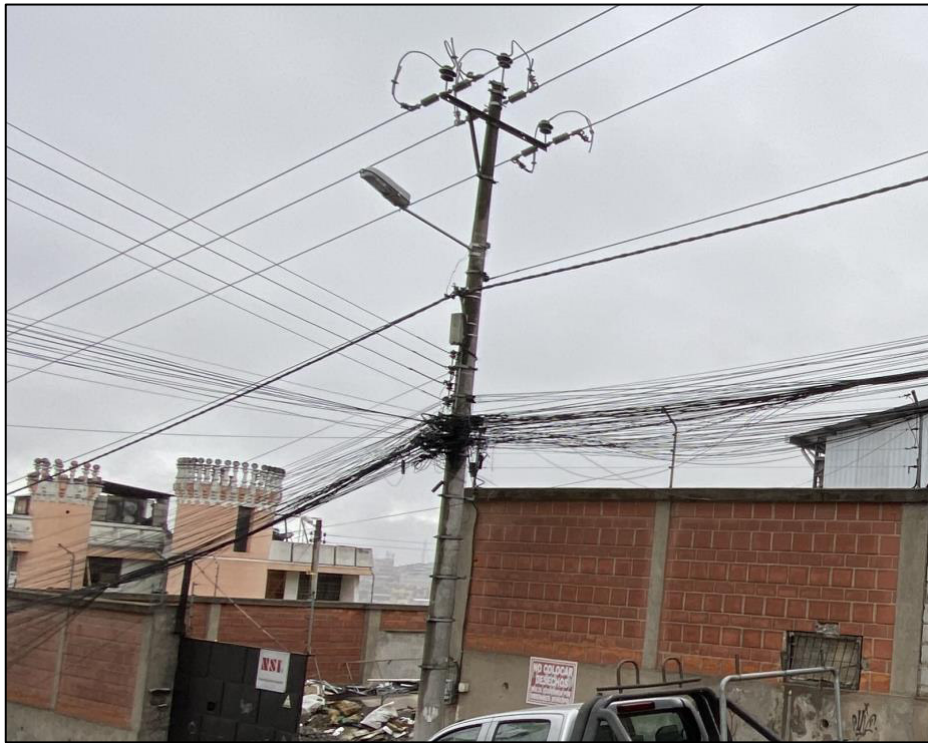
Figura 4.26. Poste existente 2 frente a fachada PROCONTEX.
