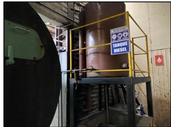
Figura 3.16. Tanque secundario de diésel.
