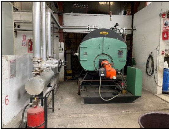
Figura 3.13. Caldero de diésel.
