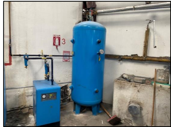
Figura 3.12. Tanque de reserva de aire
