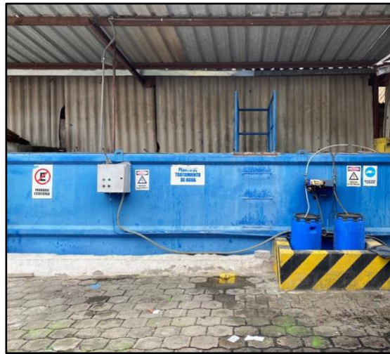
Figura 3.19. Planta de tratamiento de agua
