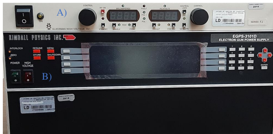
Figura 3-20. Consolas de operación colocadas en bloque en la parte superior la consola complementaria de alto voltaje (Serie FJ) y en la zona inferior consola principal (EGPS-3101D).
