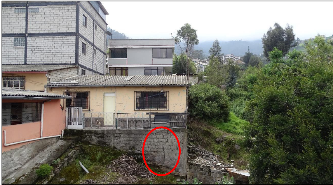
Figura 4.17 Viviendas con grietas (en rojo) en el cauce de la quebrada Habas Corral.
