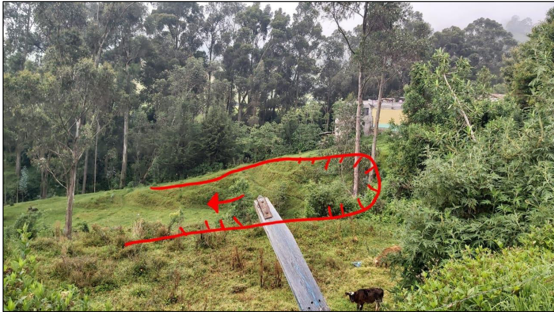
Figura 4.16 Deslizamiento rotacional (escarpe en rojo) ubicado en la quebrada Río Grande y presencia de viviendas cercanas a los taludes.
