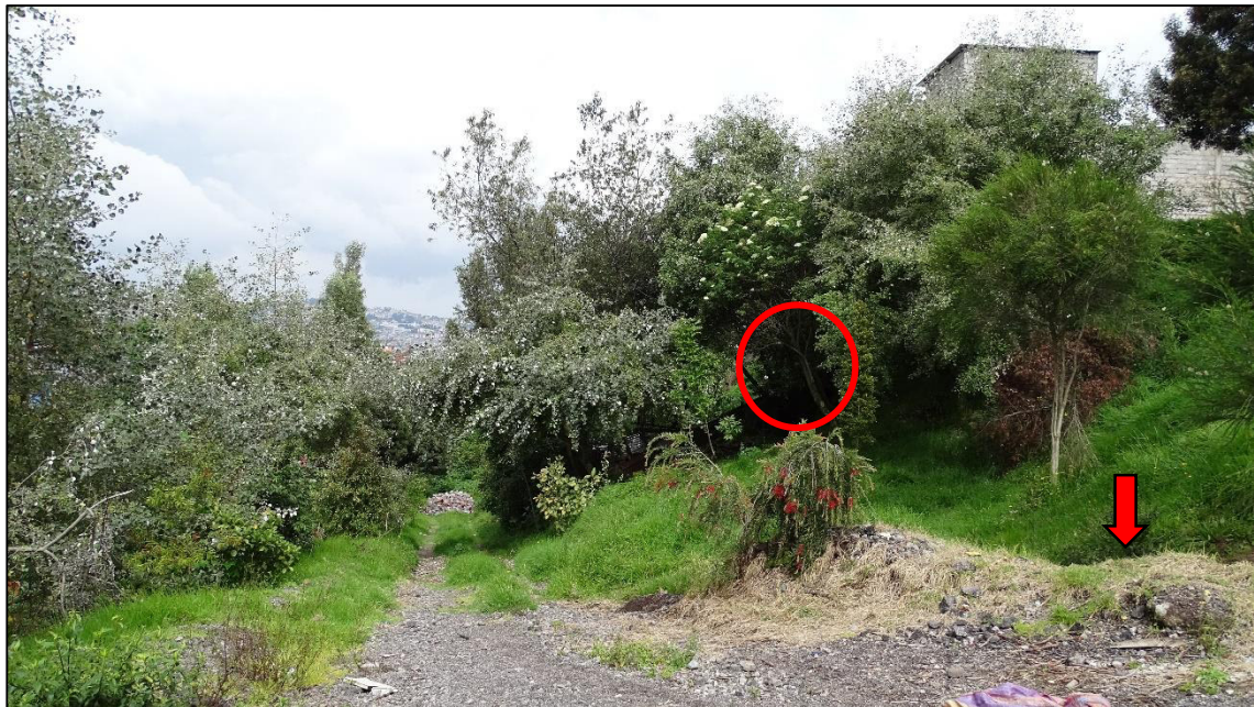
Figura 4.18 Inclinación de árboles (en círculos rojos) en la quebrada Habas Corral en zonas de relleno (flecha roja) en el talud del cauce.
