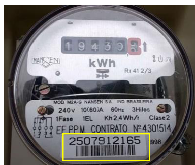
Figura 5.48 Vista de la placa de datos de un medidos de consumo eléctrico.
