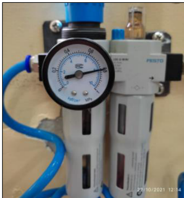
Figura 3.34 Manómetro en la parte crítica de la red.
