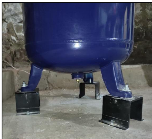
Figura 3.15 Compresor fijado al piso
