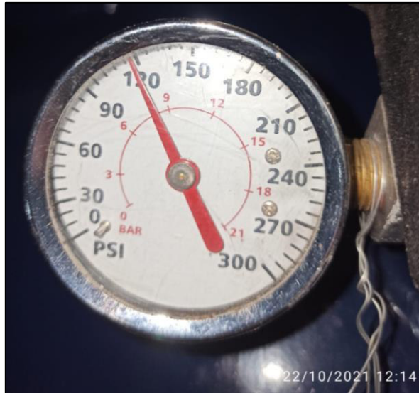
Figura 3.33 Manómetro en el compresor.
