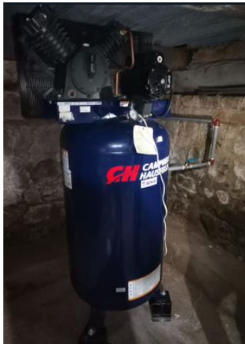
Figura 3.1 Ubicación del compresor en el cuarto de máquinas.
