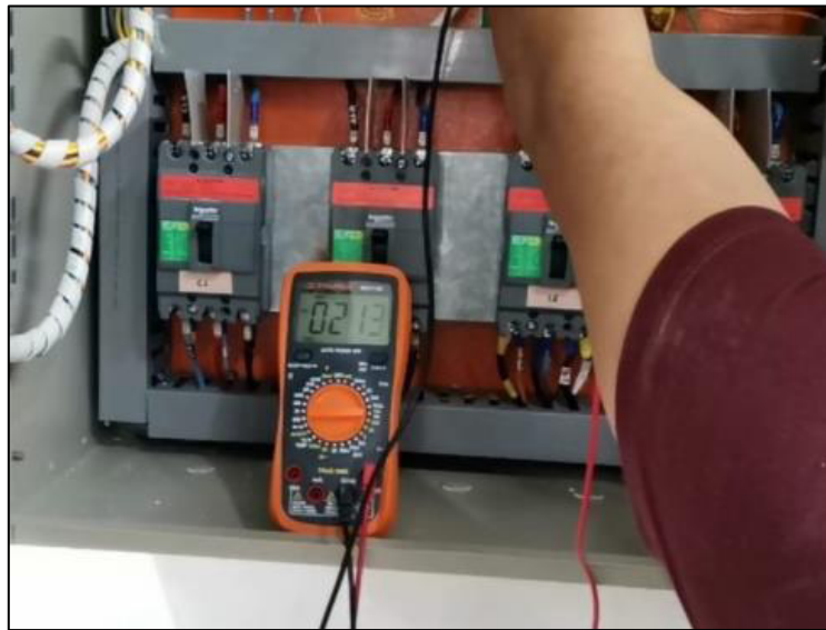
Figura 3.35 Voltaje medido en el tablero de distribución.
