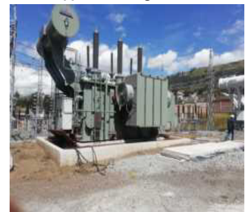
(l) Sensores de Transformador - SE Conocoto
