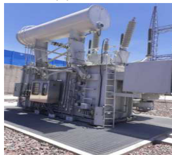
(k) Sensores de Transformador - SE Vicentina
