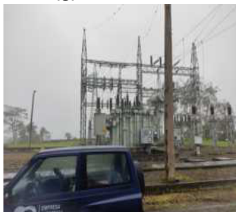
(j) Sensores de Transformador - SE Los Bancos
