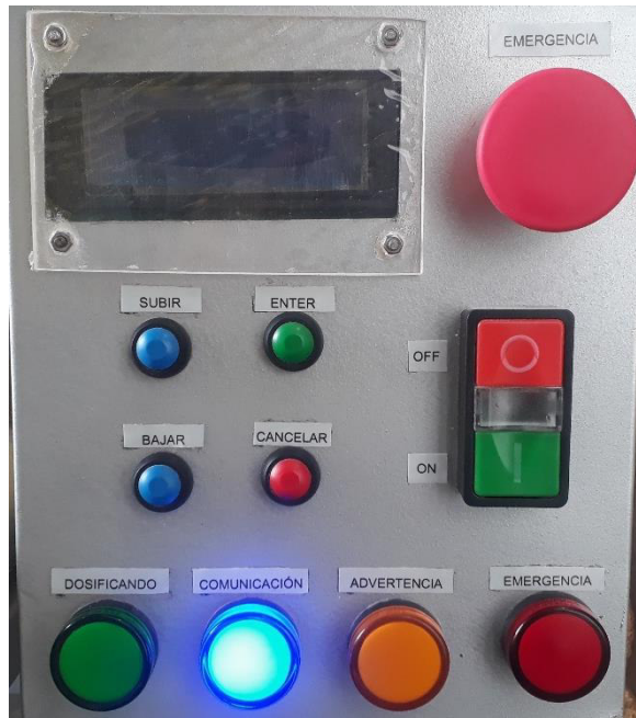
Figura 3.7. Prototipo con comunicación con el sistema general de dosificación
