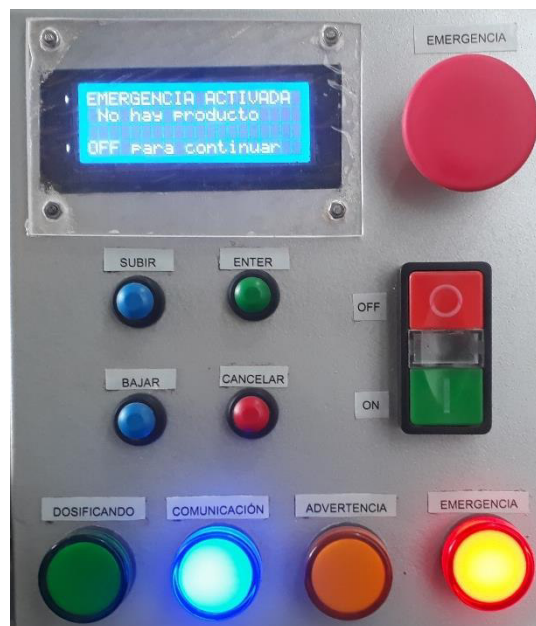
Figura 3.11. Alarma de seguridad de nivel muy bajo activada en el prototipo
