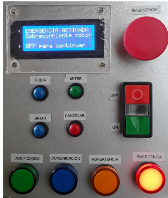
Figura 3.13. Alarma de peligro generada en el motor mostrada en el prototipo
