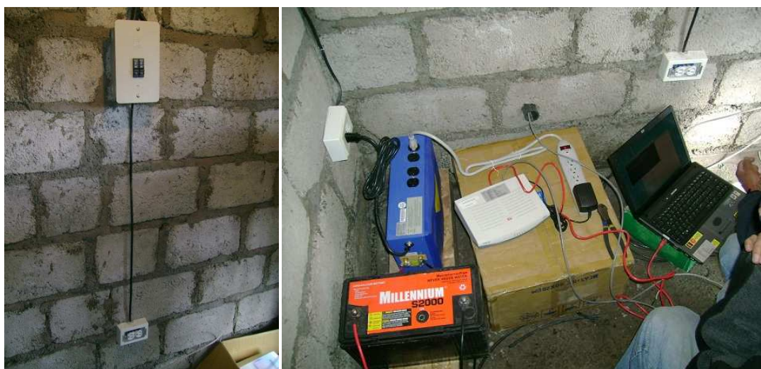
Figura 3.5 Sistema eléctrico de la caseta de equipos
