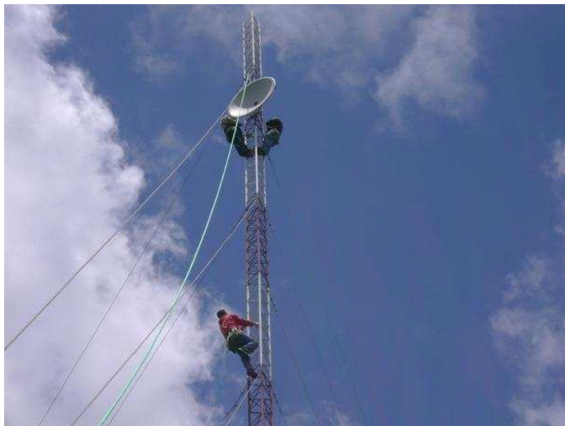
Figura 3.13 Instalación antena trayecto Atacazo-Guango
