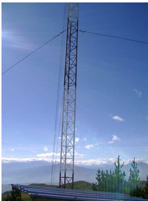
Figura 3.1 Torre con tensores y caseta de equipos
