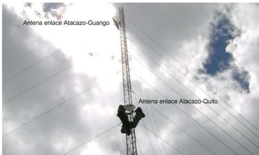
Figura 3.14 Instalación antena trayecto Atacazo-Quito
