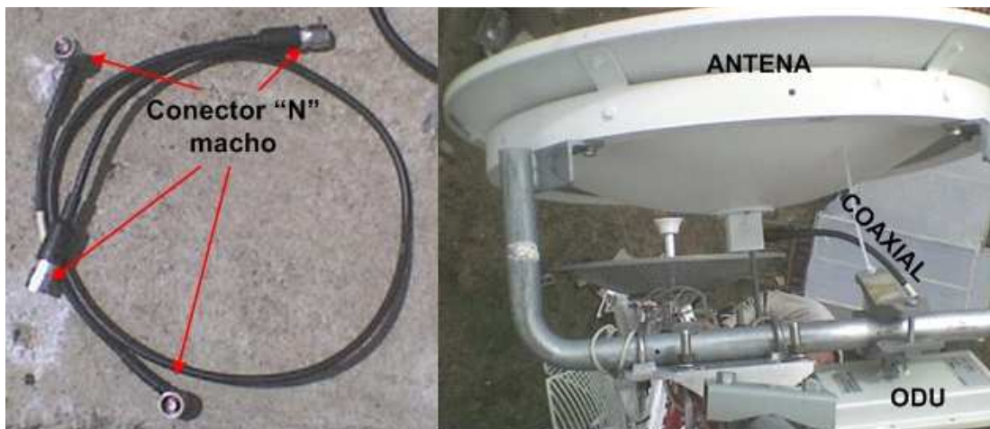
Figura 3.17 Conexión de cables de baja pérdida
