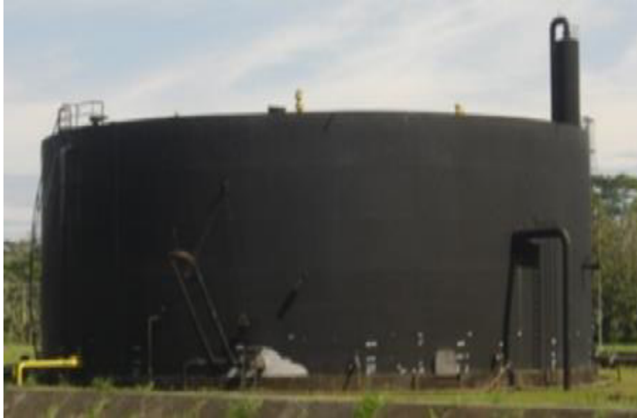
Figura 2.7. Tanque de lavado “ wash tank ” estación Sacha Norte 1 (Petroecuador, 2022)
