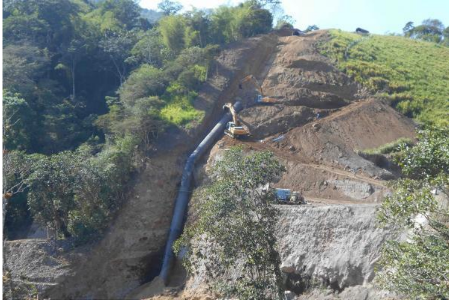
Figura 10. Tubería de presión central Palmira Nanegal
