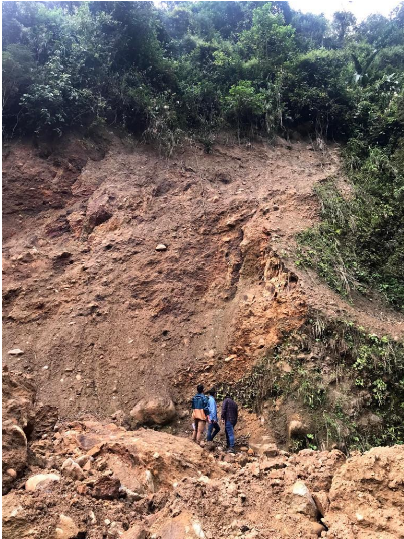
Fig.5: Deslizamiento en talud
