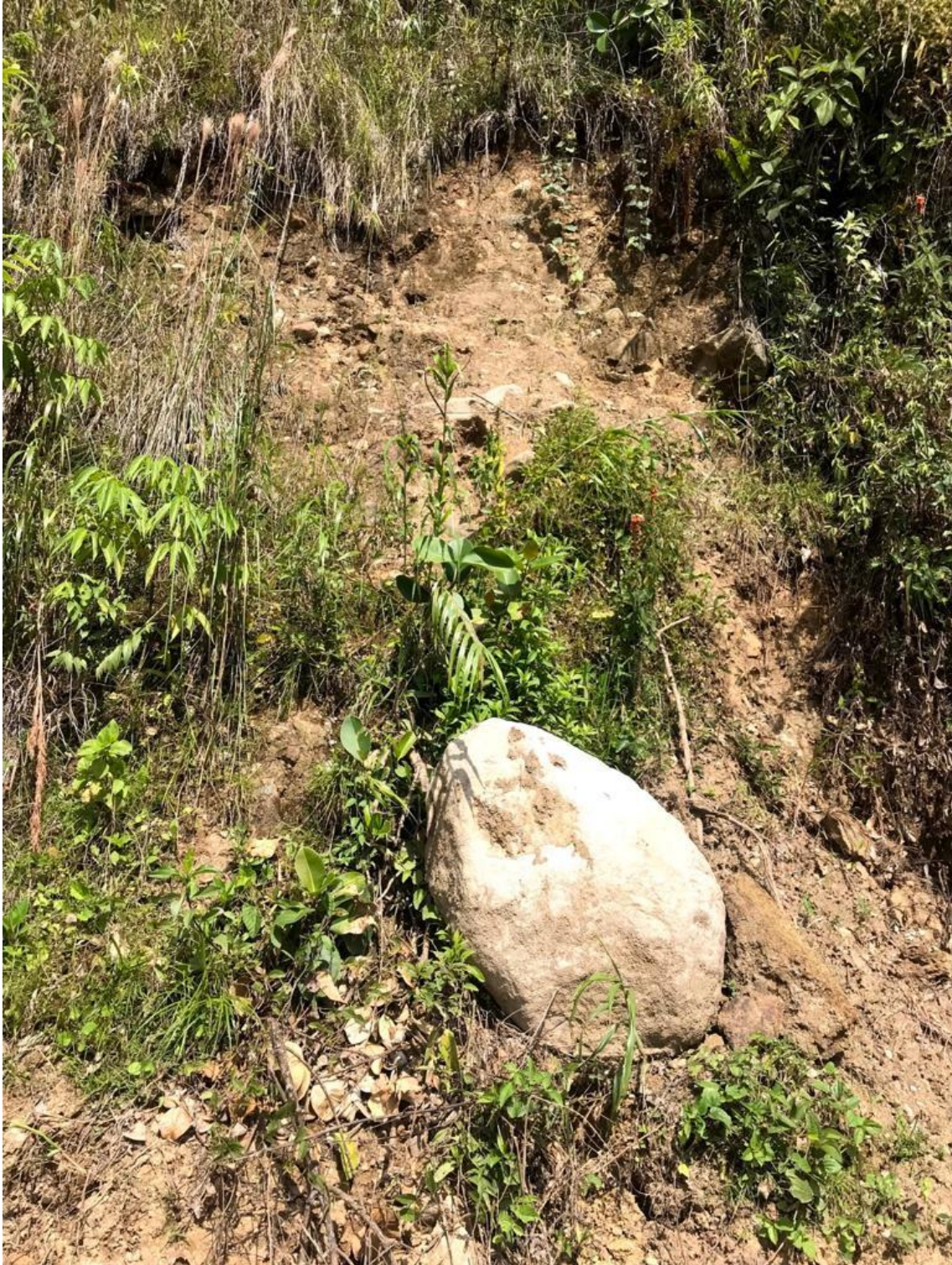
Fig.6: Caída de bloques
