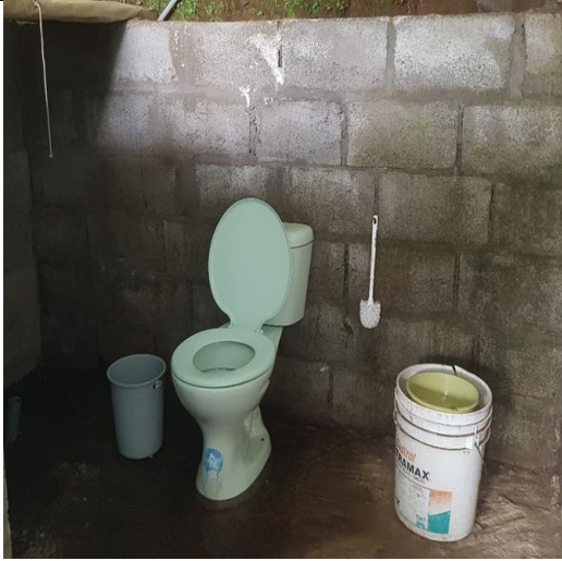
Baño conectado a pozo ciego
