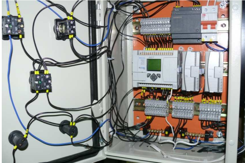
Figura N° 5 Cableado caja PLC
