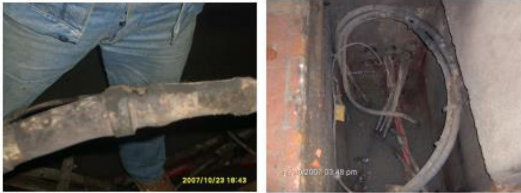
Figura 2.19. Falla en empalmes
