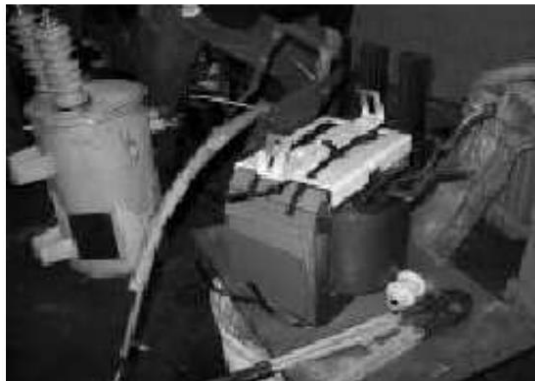
Figura 2.15. Transformador por fallado por sobrevoltaje atmosférico.
