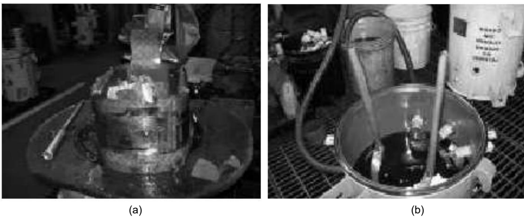
Figura 2.16. (a) Transformador con falla por circuito externo en el devanado de alto voltaje, (b) aspecto del aceite del transformador con falla.
