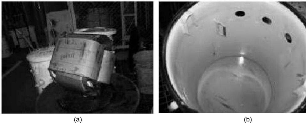
Figura 2.18. (a) Transformador con falla defecto de operación, (b) aspecto del aceite del transformador con falla.
