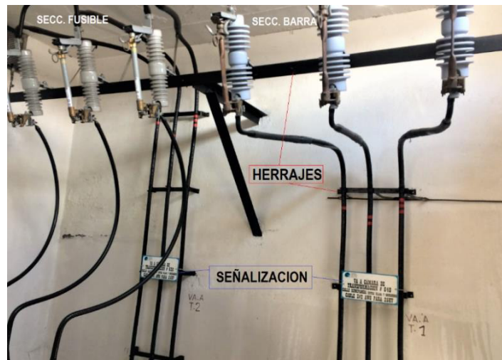
Figura 1.15. Identificación de herrajes y señalización en una cámara de transformación.
