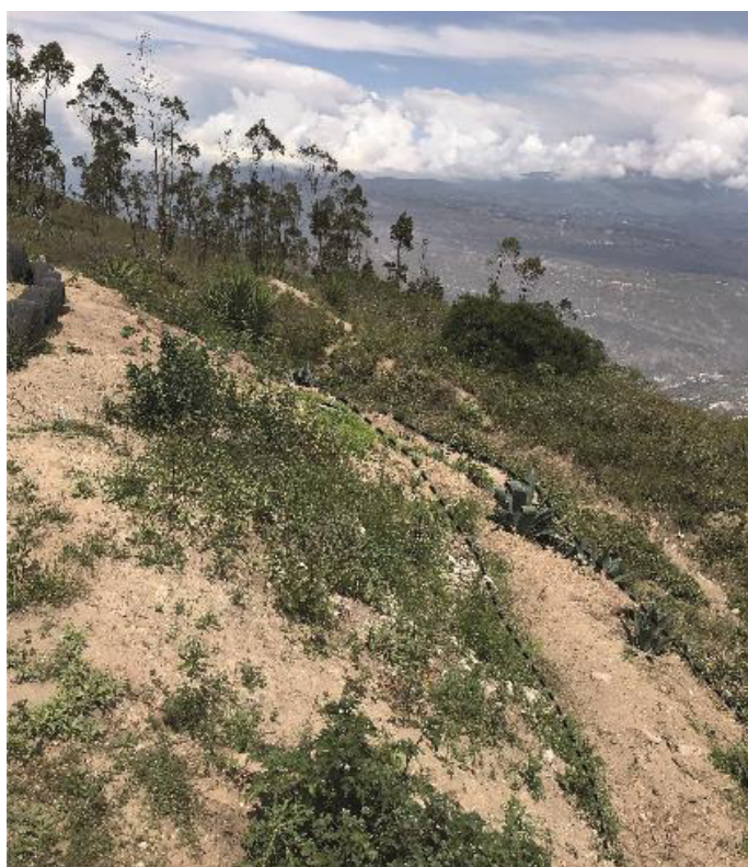
Fig. 4. 40 Fotografía de grietas de tensión paralelas al plano del escarpe en San Francisco.
