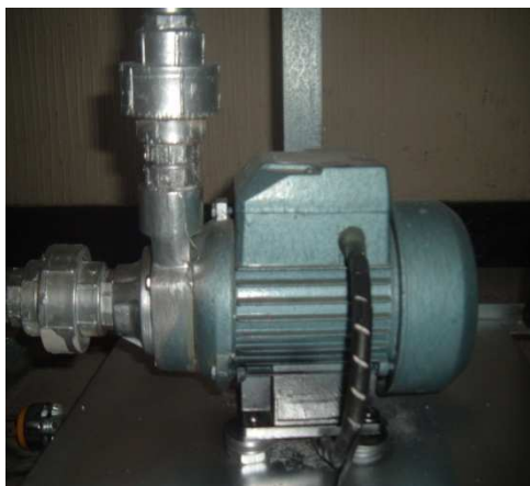
Fig. 4.5 bomba de agua
