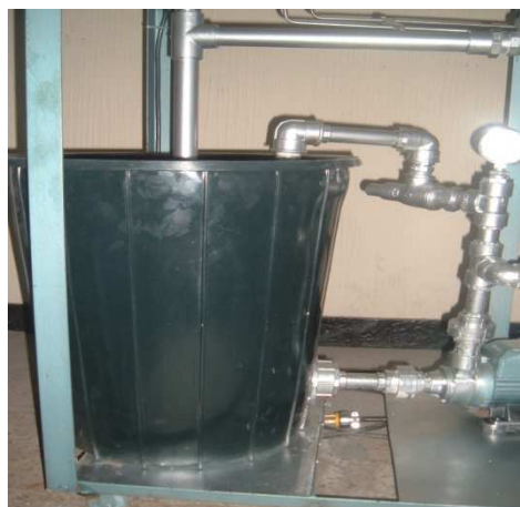
Fig. 4.6 tanque de reserva (TNQ2)
