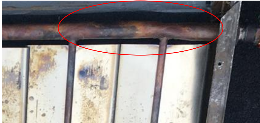
Figura 35. Colector solar ensayado luego de 15 minutos del ensayo de presión interna (Fuente: Propia).
