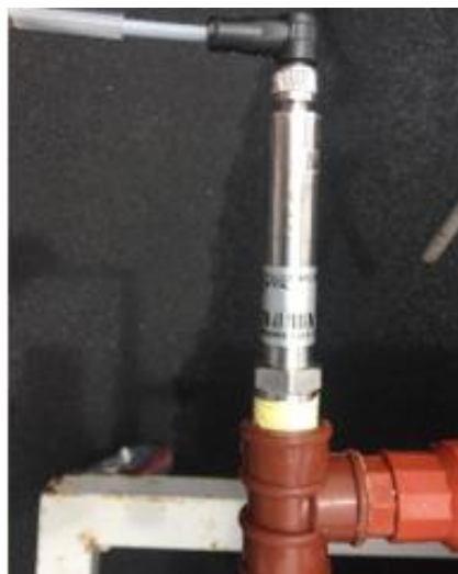
Figura 16. Adaptación PT100 a la entrada y salida del colector. (Fuente: Propia).
