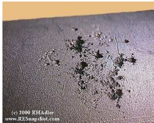
Figura 2.10 Corrosión por picaduras
