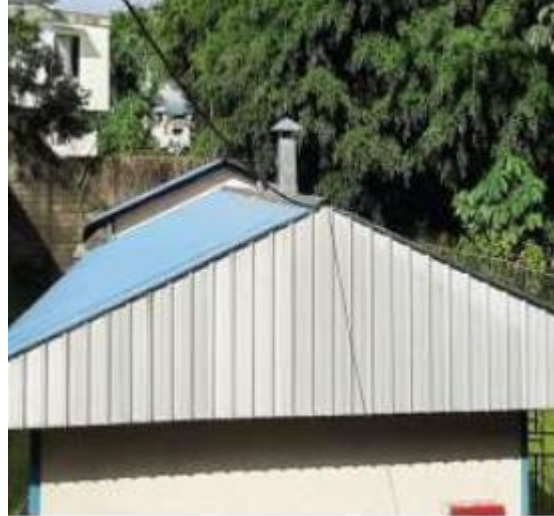
Figura AVII.13. Vista exterior de la campana de extracción
