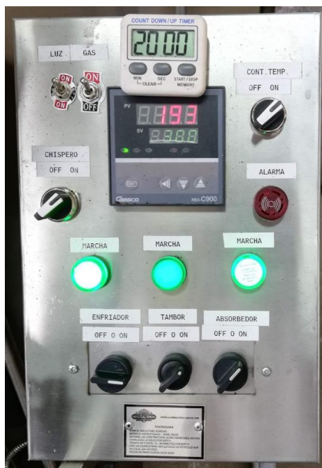
Figura 2.2. Tablero de Control del tostador de café.
