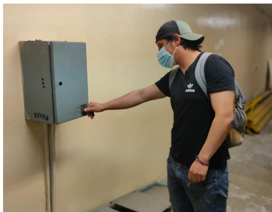
Figura C. 2 Encendido de la bomba
