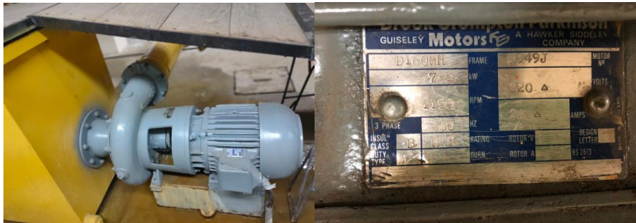
Figura C. 3. Bomba y datos de placa
