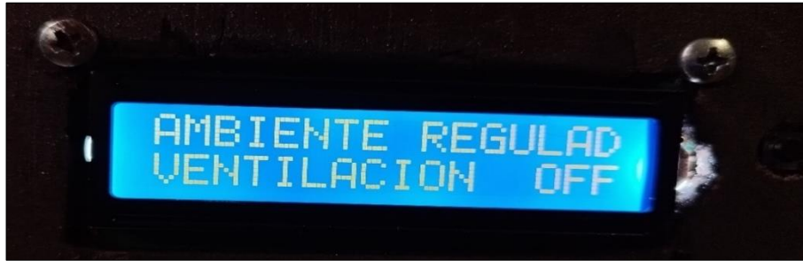
Figura 3.25 Ambiente regulado después de la acción del sistema de ventilación e inyección manual.
