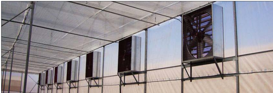
Figura 1.11 Sistema de ventilación forzada para invernadero. [33]
