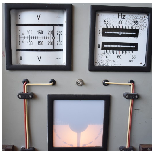
Figura 53. Comprobación de lectura de variables eléctricas con el sincronoscopio manual
