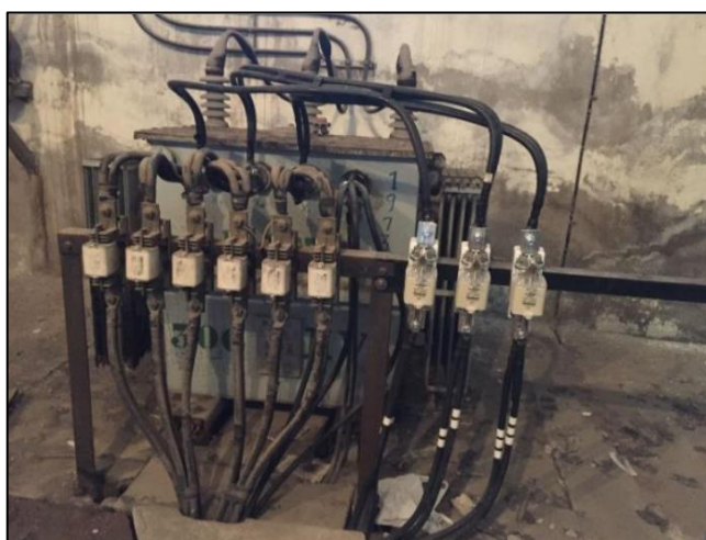
Figura 2. Transformador trifásico INATRA de la Red Eléctrica de la EEQ
