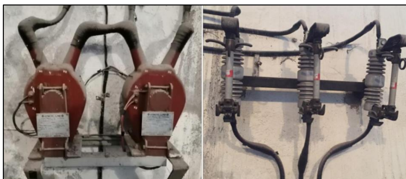
Figura 3. Transformadores de potencia Hitachi-Line y seccionadores
