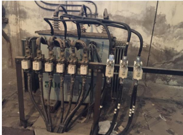
Figura 1. Transformador de 300 kVA ubicado en el edificio de Química – Eléctrica
