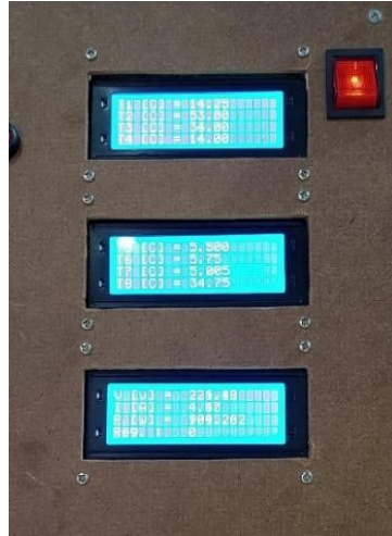
Figura XIV. XI Control de temperaturas Equipo Split
