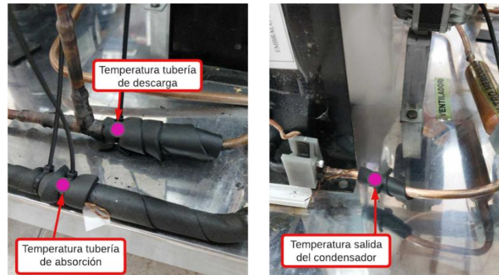
Figura IX. III Ubicación de termopares en el equipo Chiller (Fuente: Propia)
