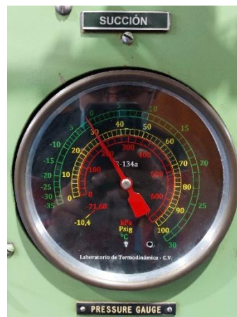
Figura X. IV Temperatura en el evaporador según el manómetro del equipo de refrigeración
