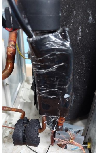
Figura XI. IV Válvula de expansión (Fuente: Propia)
