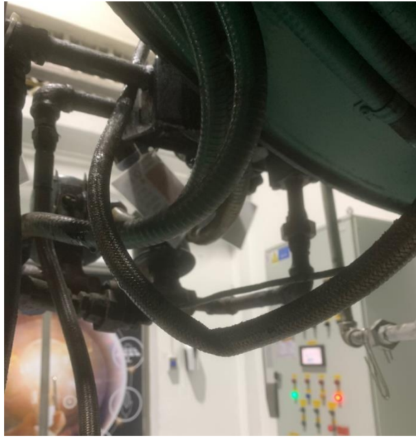
Figura 3.3. Daño en la manguera de ingreso de búnker del caldero 4 por retorcimiento. (Fuente: Autor)
