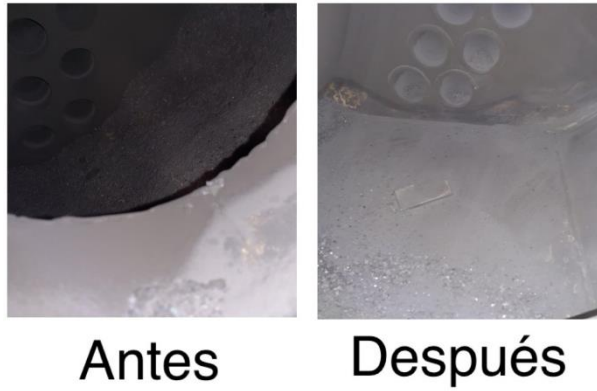
Figura 2.38. Ceniza de la parte delantera de la cámara de combustión, caldera 4. (Fuente: Autor)
