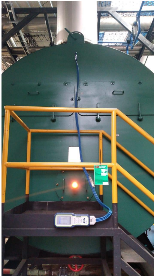
Figura 2.13. Análisis de gases en caldero pirrotubular. (Fuente: Autor)
