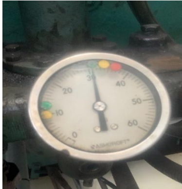
Figura 2.21. Presión de recirculación de búnker en el caldero 4. (Fuente: Autor)
