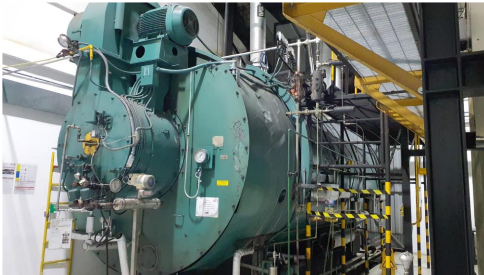
Figura 1.16. Caldero 4, 800 BHP. (Fuente: Autor)
