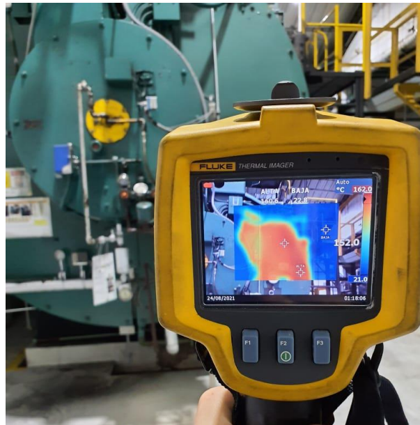
Figura 2.16. Medición de la temperatura de la pared frontal del caldero 4 (Fuente: Autor)
