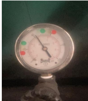
Figura 2.24. Presión de la bomba de búnker en el caldero 4. (Fuente: Autor)
