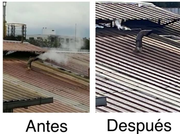
Figura 2.31. Comparación de vapor emitido al ambiente después del cambio de la válvula de cierre. (Fuente: Autor)
