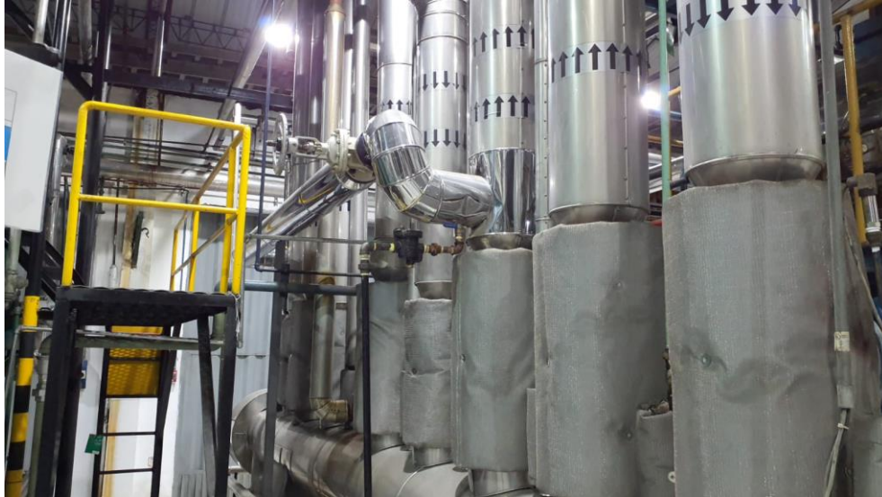
Figura 1.22. Tubería de vapor caldero 7 – desaireador. (Fuente: Autor)
