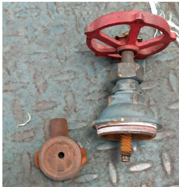
Figura 2.30. Válvula de 1 1/2"NPT en la tubería de venteo oxidada y sin cierre hermético. (Fuente: Autor)
