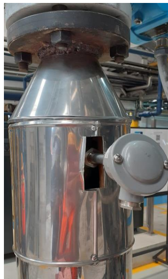
Figura 2.50. Instalación de un transmisor de temperatura a la salida de las bombas de agua de alimentación de calderos. (Fuente: Autor)
