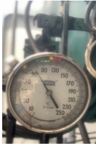
Figura 2.25. Temperatura de búnker de ingreso al quemador del caldero 4. (Fuente: Autor)
