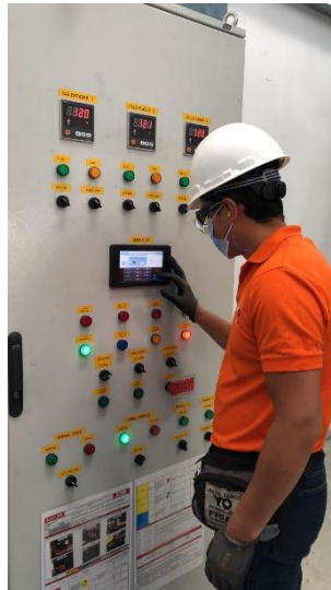
Figura 2.20. Cambio del porcentaje del punto de la curva de combustión del caldero 4 manualmente. (Fuente: Autor)
