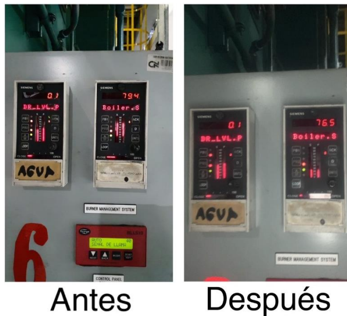
Figura 2.28. Cambio del set point de trabajo del caldero 6. (Fuente: Autor)
