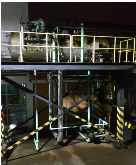
Figura 1.11. Tanque de agua desaireador antiguo. (Fuente: Autor)
