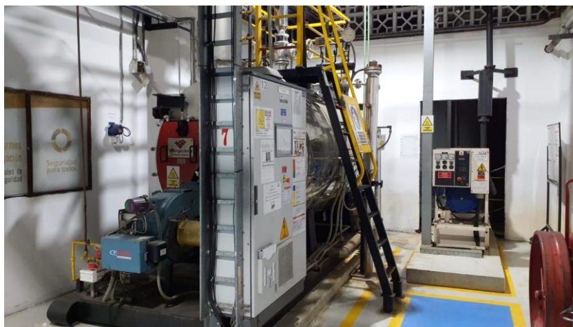
Figura 1.19. Caldero 7, 100 BHP. (Fuente: Autor)
