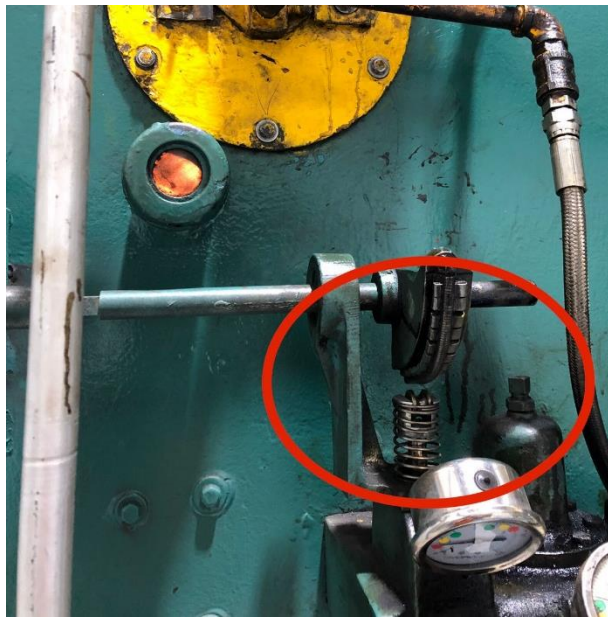
Figura 3.4. Descolocación en la leva del sistema de combustión del caldero 4 (Fuente: Autor)
