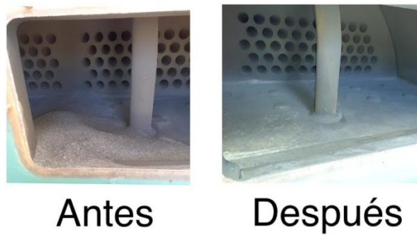
Figura 2.40. Ceniza de la parte trasera de la cámara de combustión, caldera 4. (Fuente: Autor)
