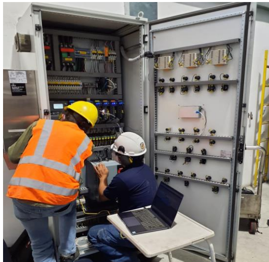
Figura 2.47. Modificación del control del caldero 4. (Fuente: Autor)
