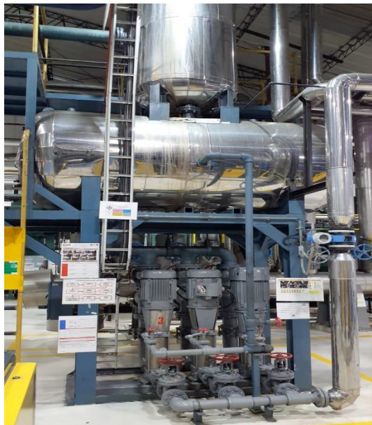
Figura 1.13. Desaireador de agua de alimentación a calderos. (Fuente: Autor)
