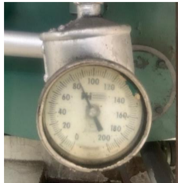
Figura 2.22. Temperatura del aire de atomización en el caldero 4. (Fuente: Autor)
