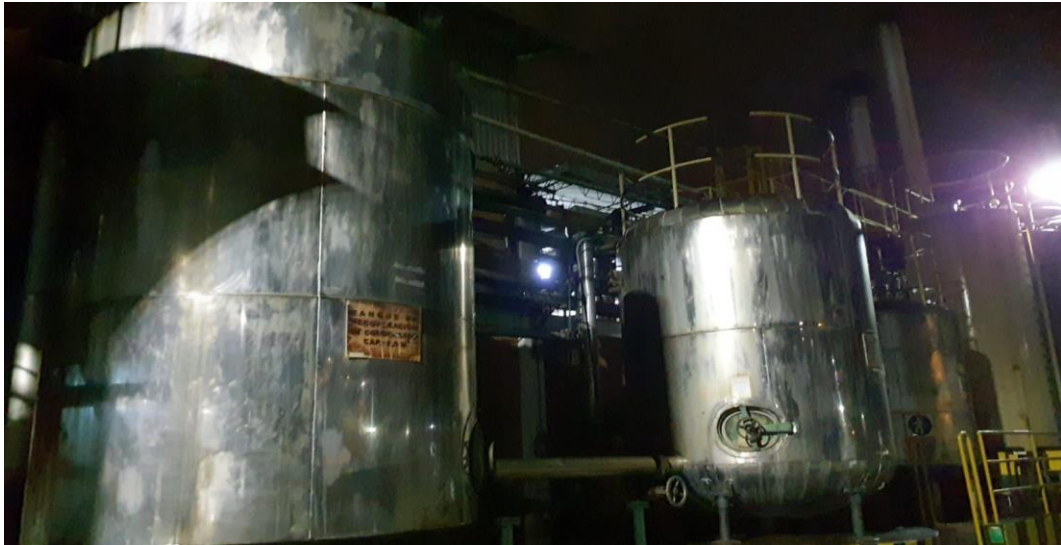
Figura 1.10. Tanques de agua ablandada para generación de vapor. (Fuente: Autor)
