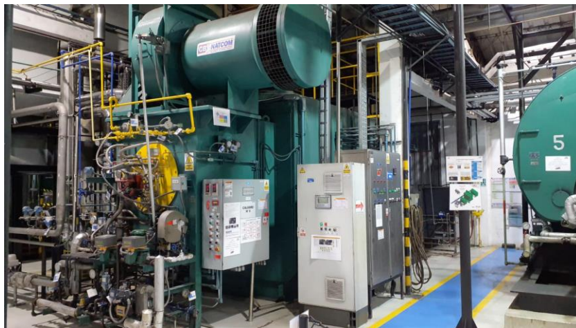
Figura 1.18. Caldero 6, 1304 BHP. (Fuente: Autor)
