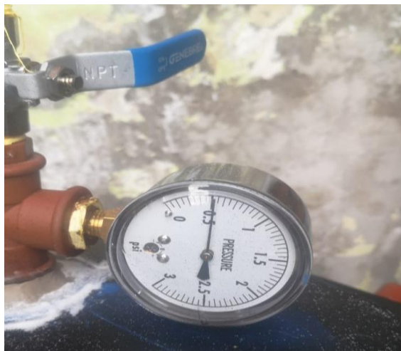
Figura 2.20 Lectura de manómetro con carga. Fuente: Propia
