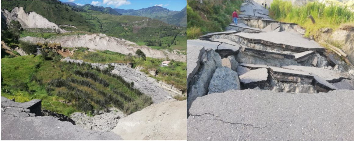
Fotografía 6.1 Destrucción y pérdida de las calles en el sector valle de La Armenia
