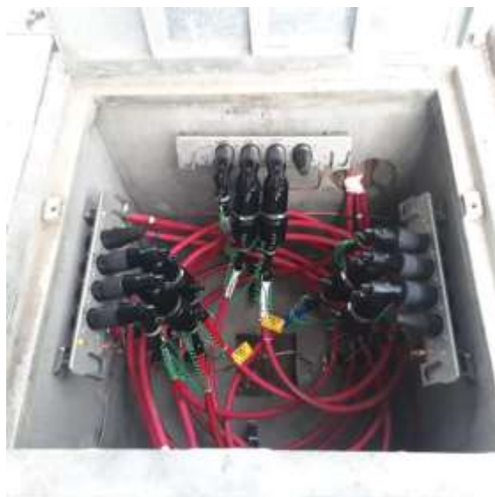
Figura 3.12. Pozos subterráneos para los SED.
