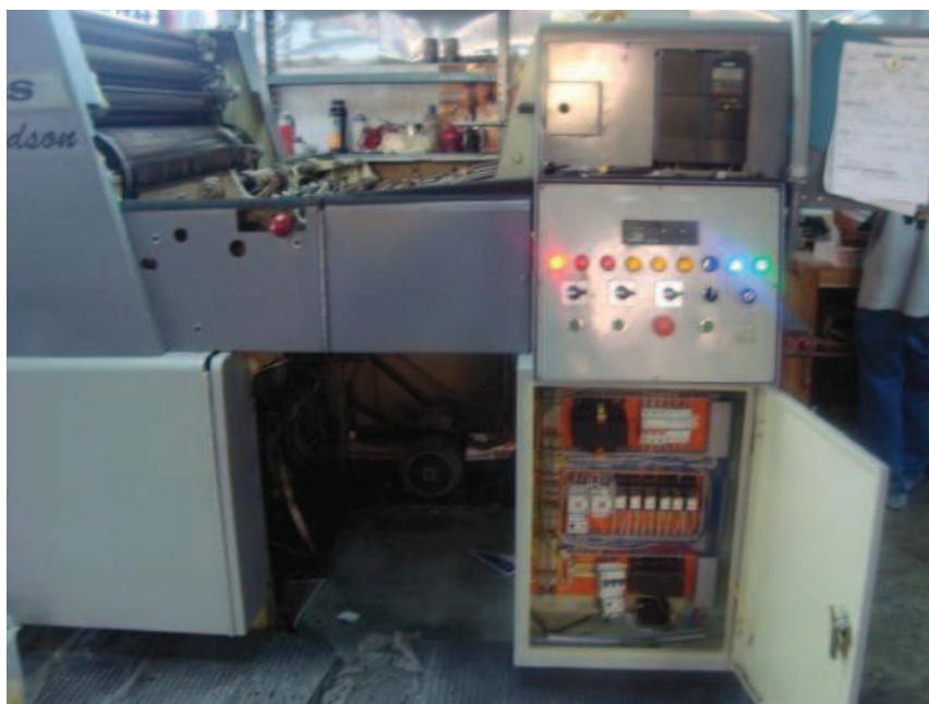
Figura 2.12 Tablero de control repotenciado, Imprenta Don Bosco.
