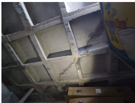
Imagen 1 Grieta de infiltración
