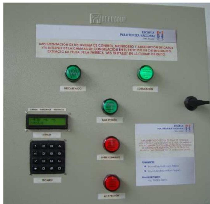
FIGURA 4.3: Elementos de señalización: teclado y LCD.
