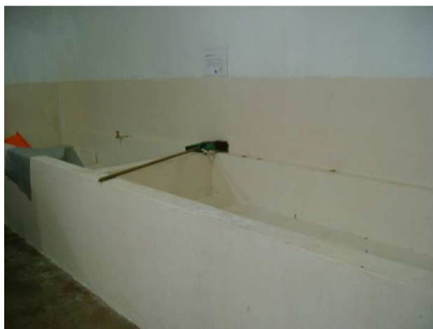
FIGURA 1.5: Tanques de prelavado y desinfección.
