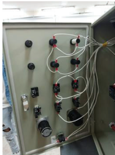
Figura 2.24 Cableado no templado.
