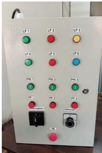
Figura 3.1 Tablero entregable para laboratorio de LTI-IE.
