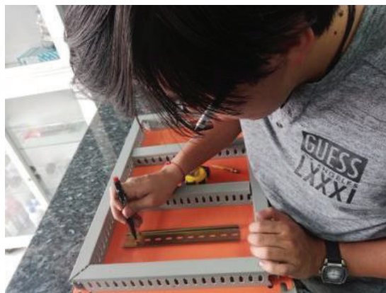
Figura 2.15 Comprobación Canaleta y Riel Din del panel interno.
