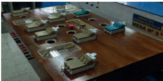
Fig.16. Módulo de adquisición de datos y control de equipos resultado de la emulación de un sistema SCADA [18].
