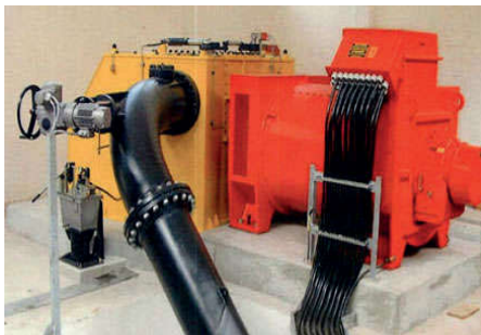
Fig. 5. Central hidroeléctrica Perlabi, Generador [4].
