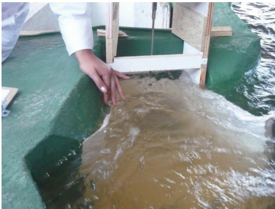
Fotografía No. 10: Problema en la pila derecha de la estructura de entrada.
