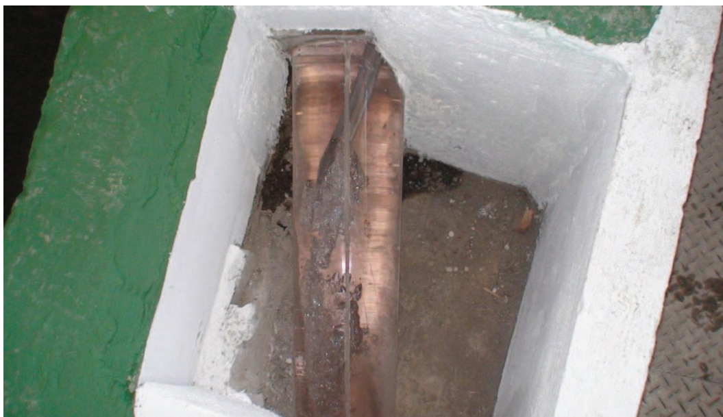
Fotografía No. 45: Vista superior del funcionamiento de la estructura de ingreso de aire en el tramo inicial del Túnel de Desvío, Q_{TD} \approx 1.130 \text{ m}^3/\text{s} .
