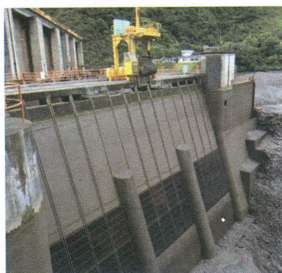
Fig. 1. Pórtico Limpia rejillas y Toma de carga de la Central Agoyán (fotografía tomada en un lavado de embalse).
