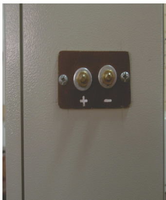
Rectificador de Corriente Continua. Vista Lateral Derecha
