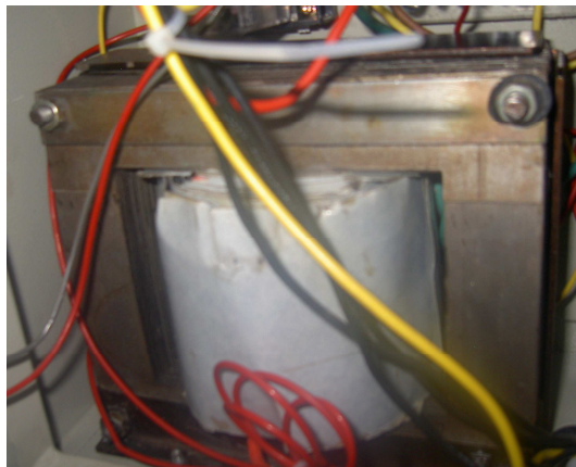
Elemento Transformador de Corriente.
