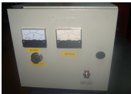
Rectificador de Corriente Continua. Vista Frontal
