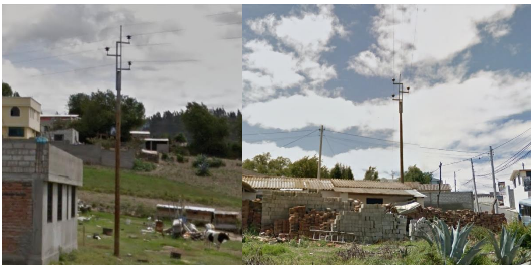
Figura 2.3. Fotografías de postes pasantes que sostienen la línea de subtransmisión Illuchi 1 – El Calvario.
