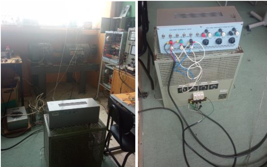
Figura D1. Módulos de carga para la prueba de conexión y desconexión de carga al grupo motor generador con su GOV
