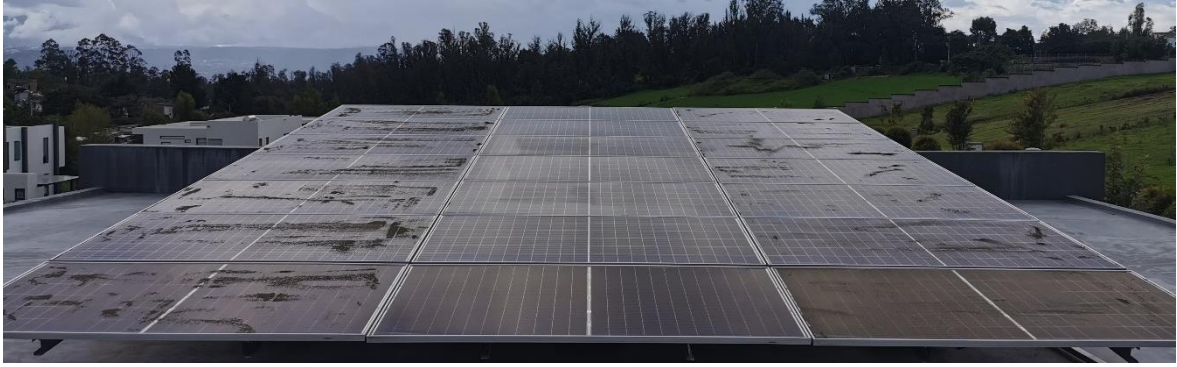
Figura 3.5. Central fotovoltaica 1, escenarios de suciedad [Elaboración Propia].
