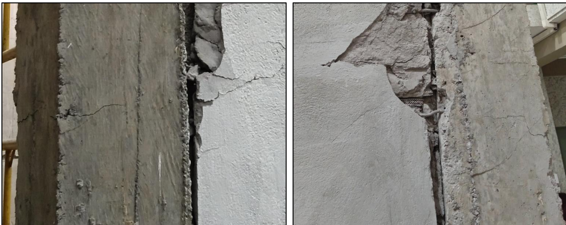
Figura 83: Fisuras en columnas
