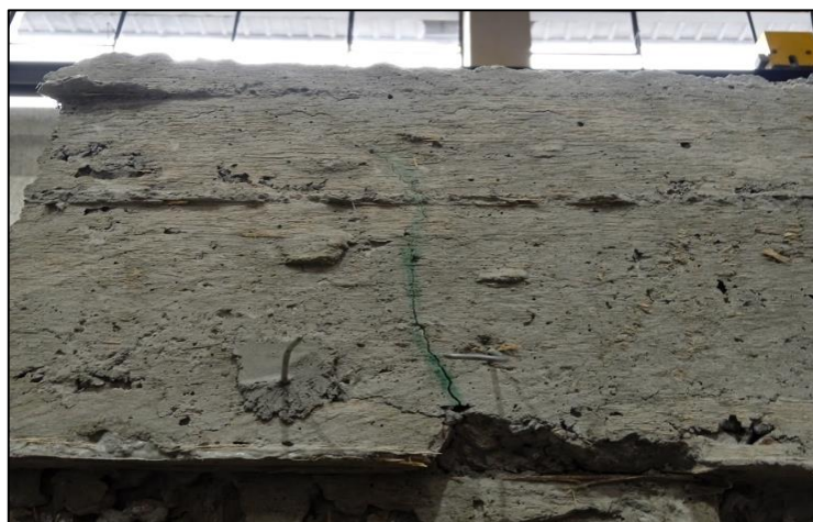
Figura 79: Primera señal de falla en unión viga columna
