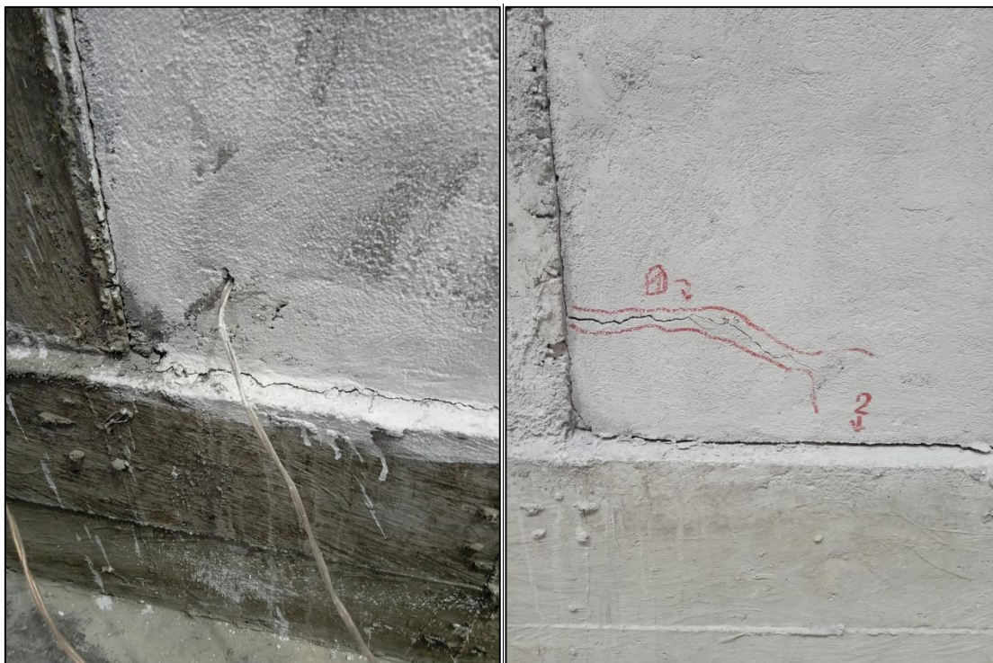
Figura 81: Desprendimiento de mampostería en viga base y columnas
