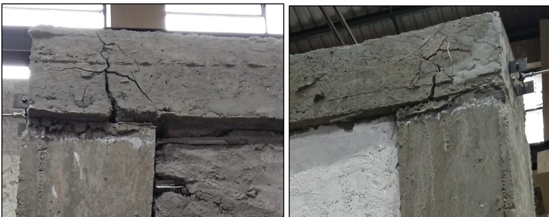
Figura 84: Fisuras en conexiones viga-columna
