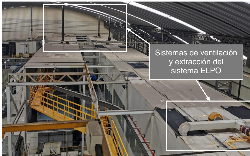
Figura 2.2 Fachada estructura del sistema Elpo de la empresa CIAUTO LTDA. (Fuente: Propia)
