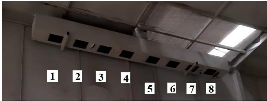
Figura 2.5 Puntos de medición en la campana de extracción del sistema Elpo (Fuente: Propia)
