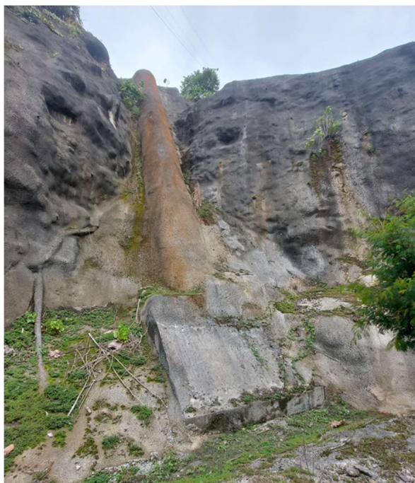
Figura 8. Tubería de Presión Central Palmira Nanegal
