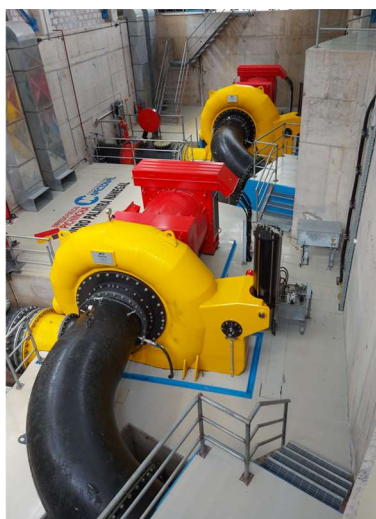
Figura 12. Turbinas Francis de Eje Horizontal Central Palmira Nanegal
