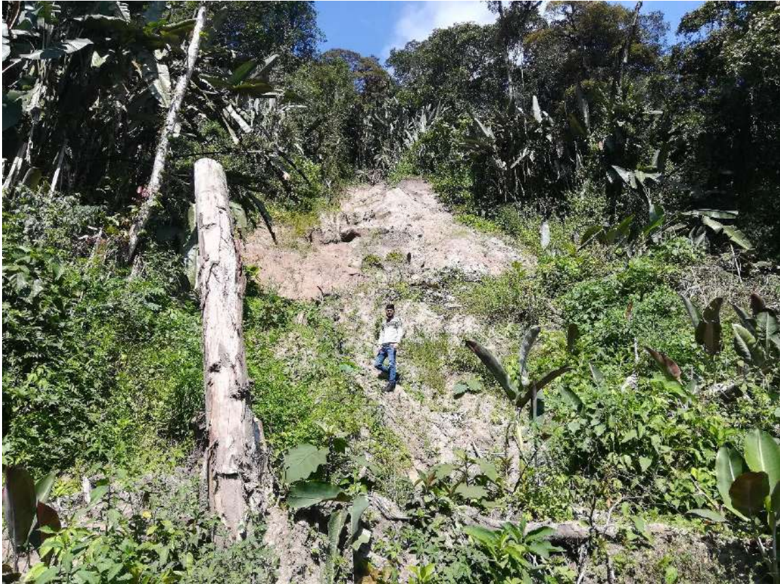
Figura 15. Deslizamiento en talud cerca del Poblado de Tandayapa (UTM: 758740-10001053, UTM zona 17S).
