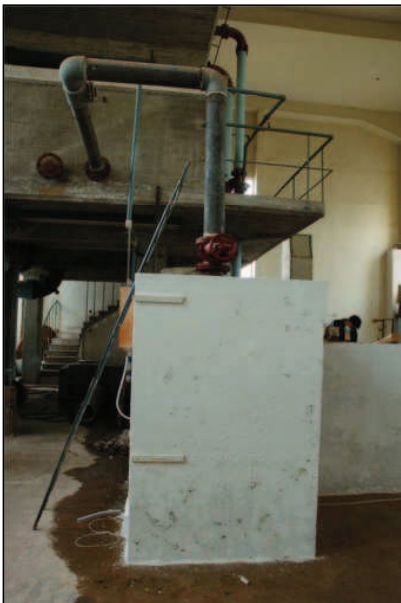
FOTOGRAFÍA 3.3 TUBERÍA DE ADMISIÓN
